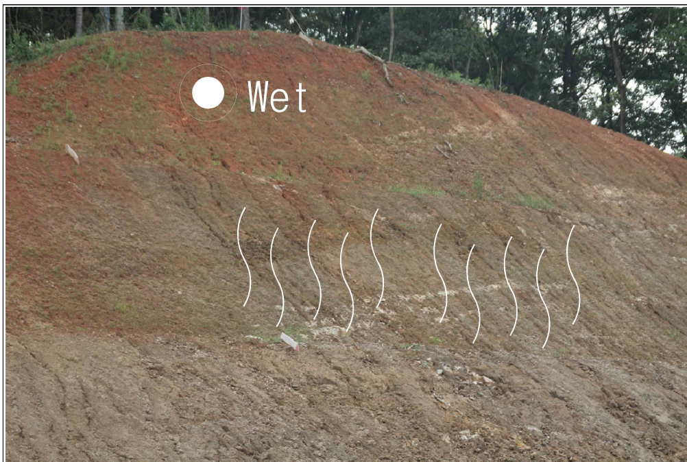
【그림 15】 A 영역 상세사진 (토사유실 및 우류침식, 지하수 유출)
