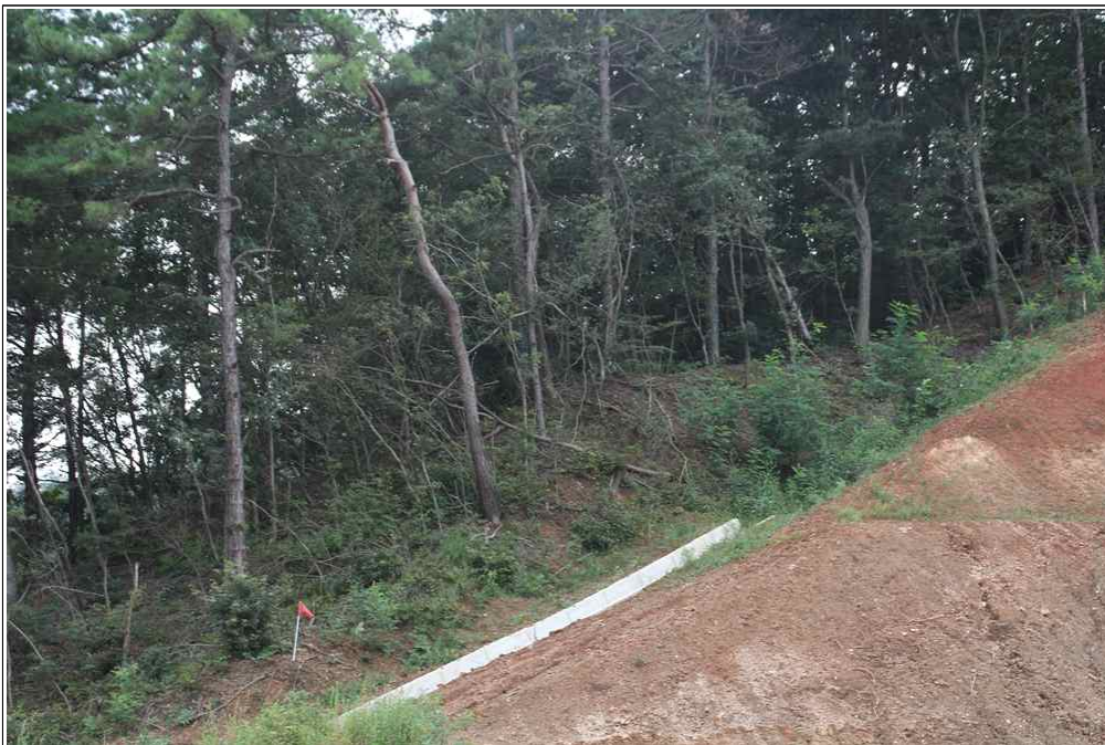
【그림 6】 상부 자연비탈면 (수목의 기울어짐 및 포행)
