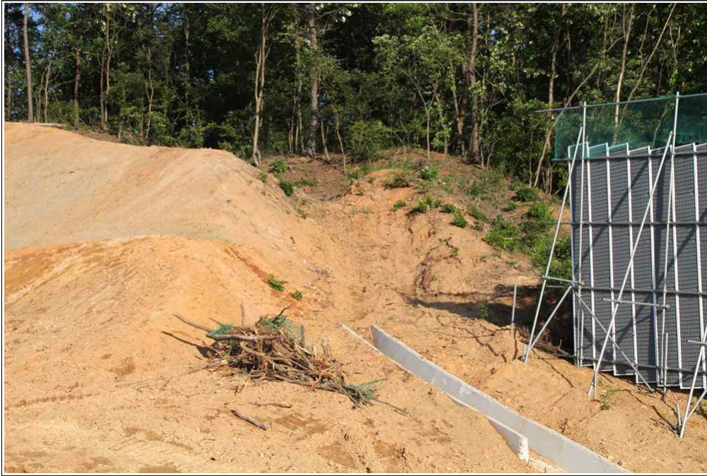
【그림 5】 상부 자연비탈면 (수목의 기울어짐 및 포행)
